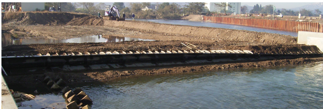
写真 3.1.1 径間の 1/3 のみに堆砂した場合の状況
