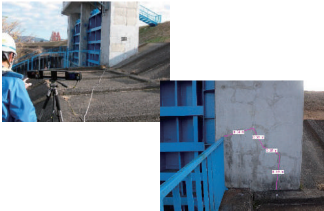
出典) 中部地方整備局
