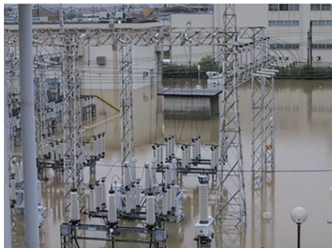
図1 浸水による変電所の冠水 出典：国土交通省「水害の被害指標分析の手引（H25 試行版）」（2013年7月） 2)
