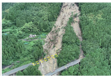
図 3 高知自動車道の土砂崩れ 大豊 IC～新宮 IC
