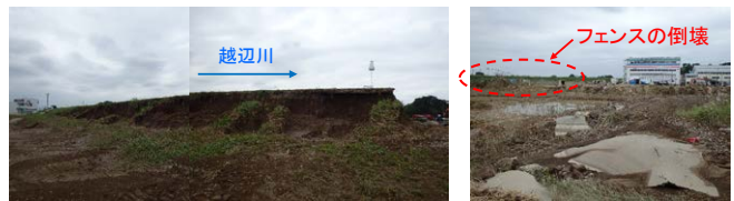
写真1 おっべ 越辺川右岸0.0kの決壊状況
