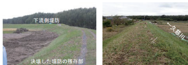
写真2 久慈川左岸 27.0k の決壊状況
