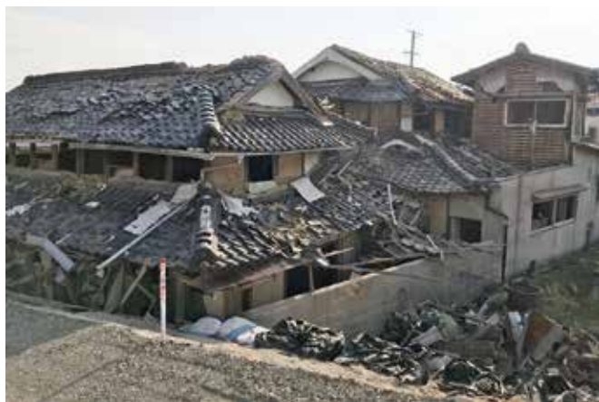
図 4-8 爆風により屋根瓦が飛散した住家
