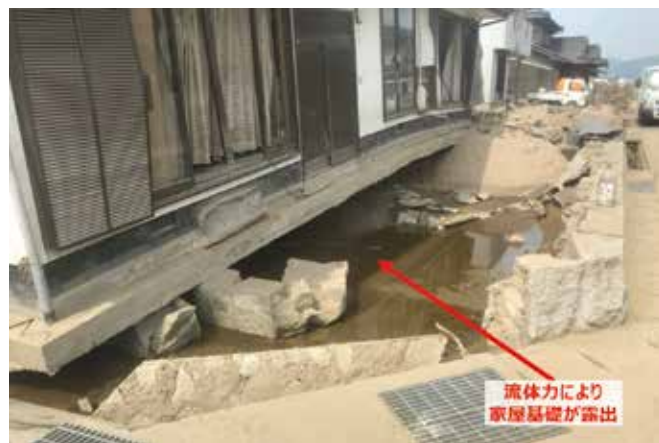
図 4-3 小田川の堤防決壊点周辺の家屋の被害状況
