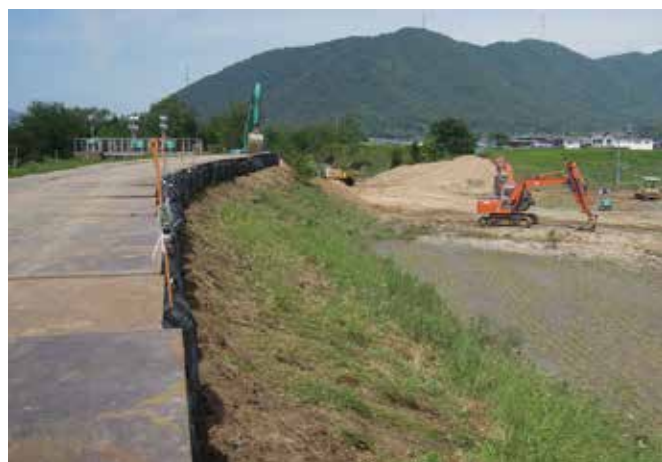
図 3-5 小田川 6.4k 堤防決壊状況 (7/13 調査時)
