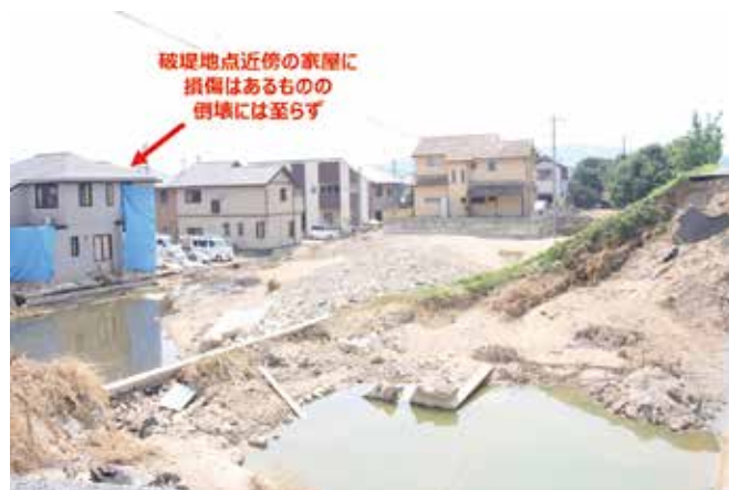
図 4-4 末政川の堤防決壊点周辺の家屋の被害状況
