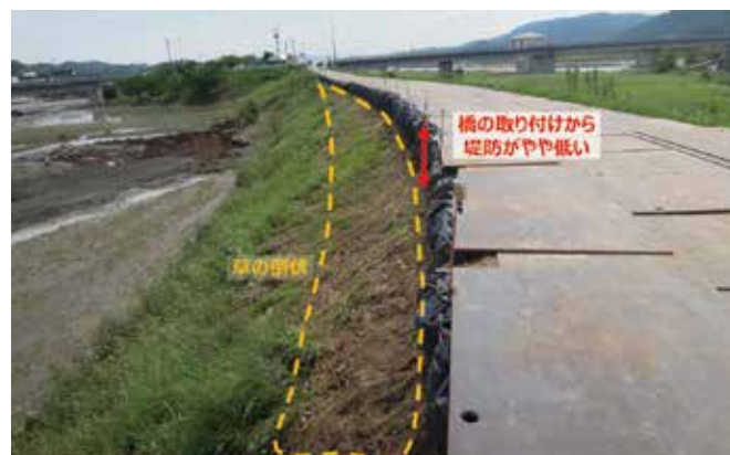
図 3-6 堤防決壊箇所下流側の堤防天端付近の状況
