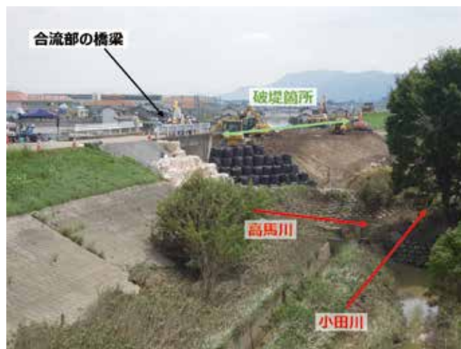
図 3-2 小田川 3.4k 堤防決壊状況（7/13 調査時）
