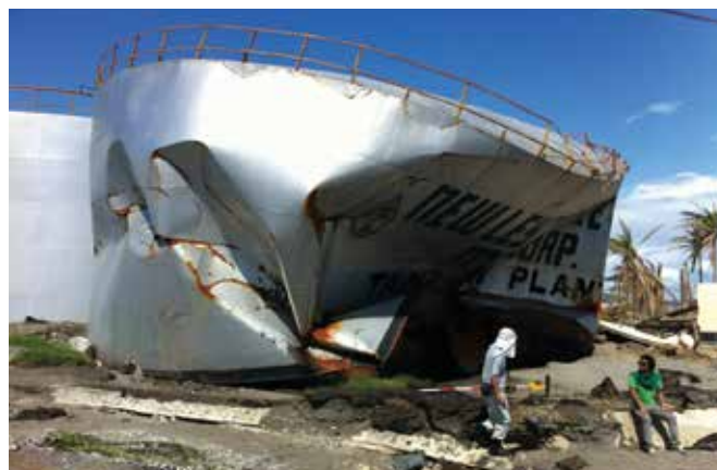
写真 1-1 台風ハイエンによる被災の様子
