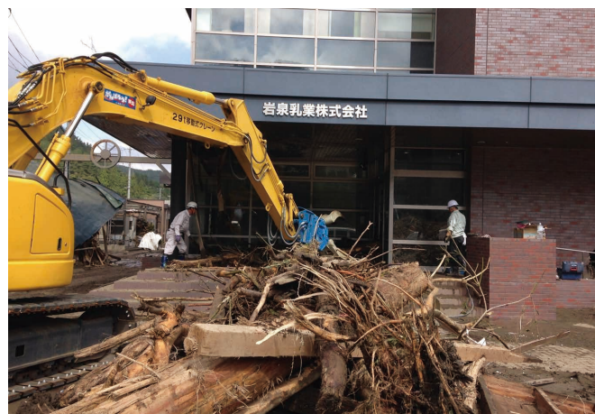
写真-7 本社玄関の流木撤去状況
