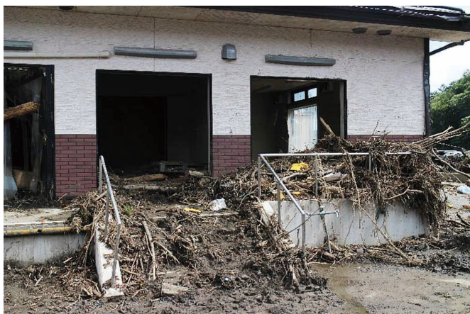
写真-2 第三工場建屋の被災状況
