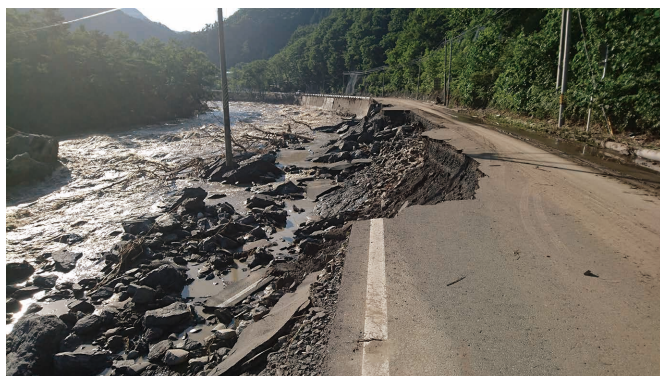
写真-6 小本川沿いの国道455号の被災状況
