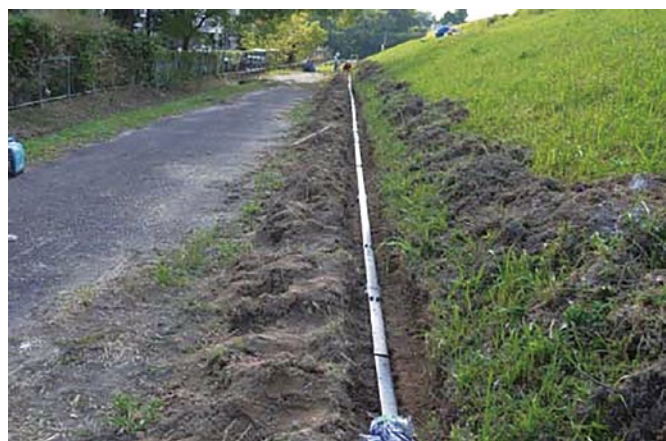
写真 4-1 のり尻における光ファイバセンサの設置状況
