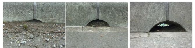
図 2-4 歩車道境界ブロック排水孔の目詰まり状況
