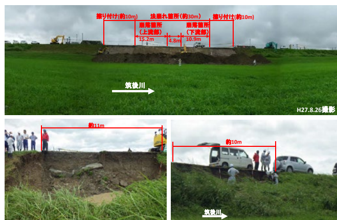
写真 2-1 被災箇所全景
