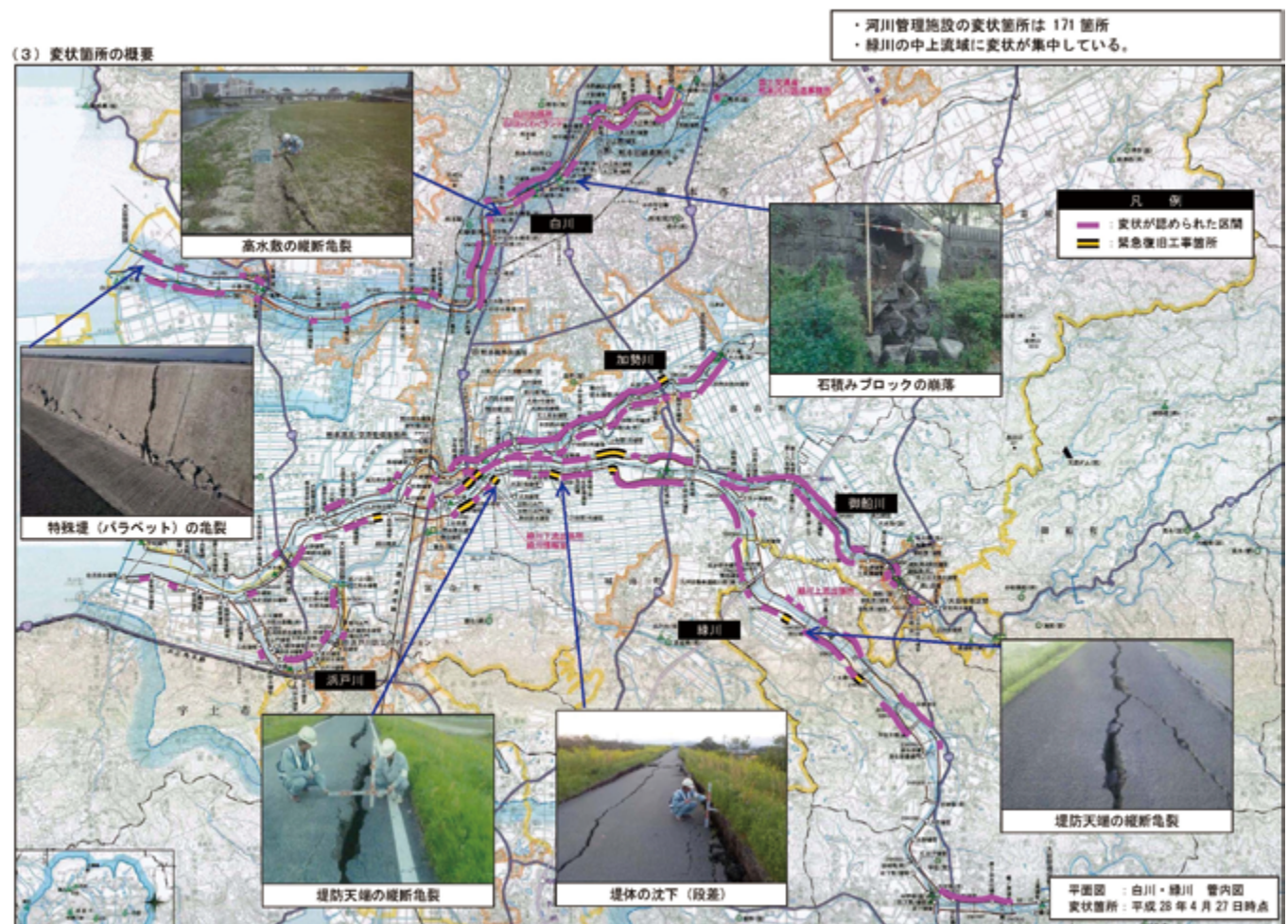
図1.2.1 国土交通省九州地方整備局熊本河川国道事務所管内において河川堤防の変状が認められた区間 [14] より転載
