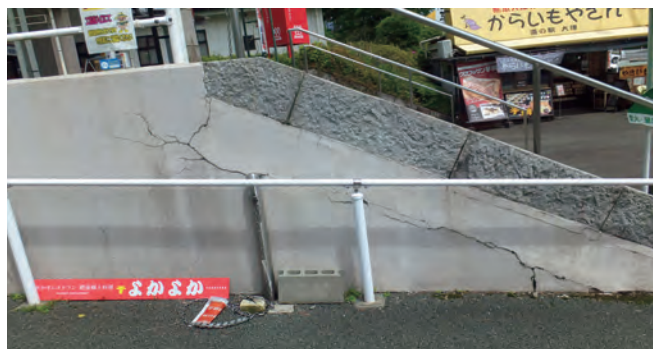
写真2-4 施設入口部階段の破損状況
