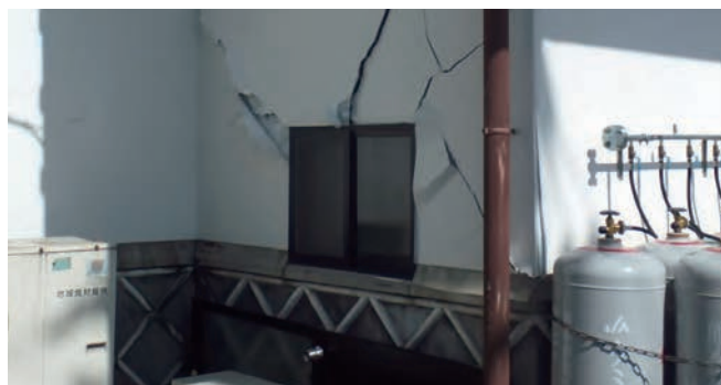
写真2-3 建物の破損状況
