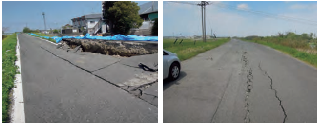
写真3-3 緑川における堤防被災（JICE調査） （左：左岸8.5k付近、右：左岸15.3k付近）
