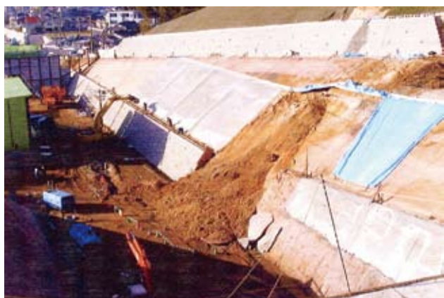
図-2 切土法面の崩壊部
