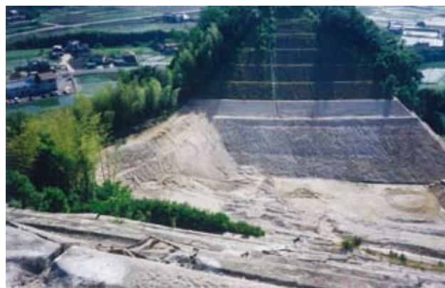
(b) 造成宅地側の頂部から 写真手前の吹き付け工に亀裂が認められる
