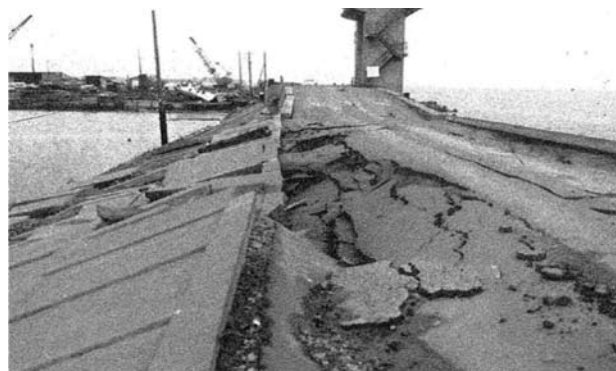
写真－5 堤防の被災状況
