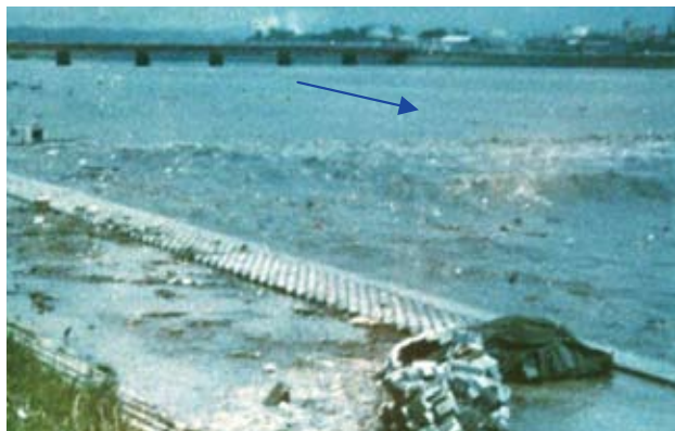
写真－1 津波によりめくれた護岸天端保護工 出展：「昭和58年5月26日 日本海中部地震災害記録」
