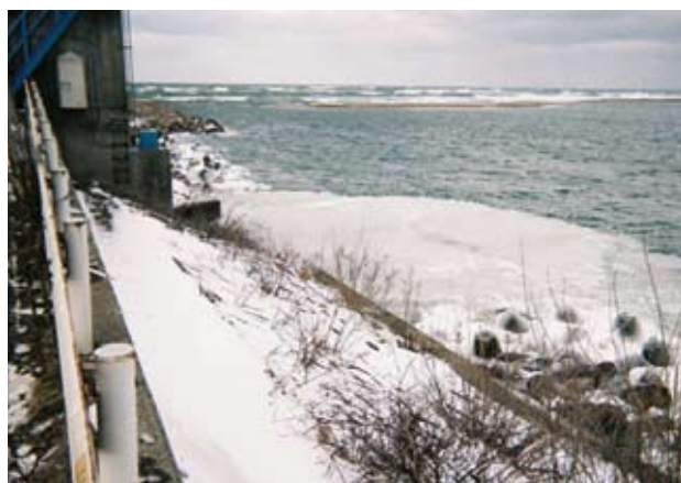
写真－3 河口部樋門付近の氷結状況
