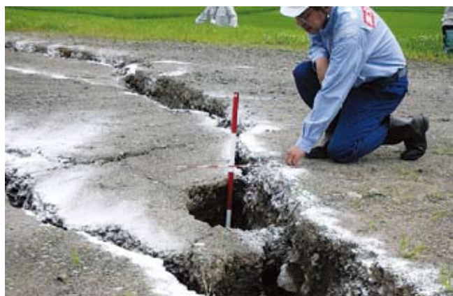
写真-8 鯖石川左岸 9.5k の被災
