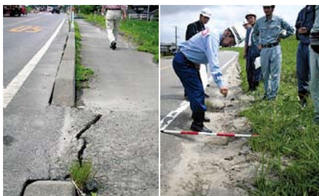
写真-4 裏のり小段の兼用道路の亀裂と噴砂
