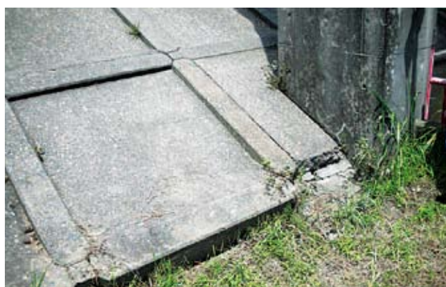
写真-3 町軽井樋管取り付け護岸の段差・目地開き
