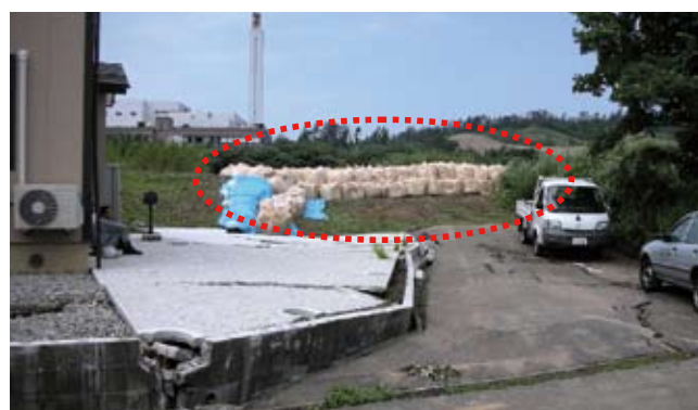
写真-6 鯖石川左岸 2.5k。赤丸部分が堤体沈下箇所
