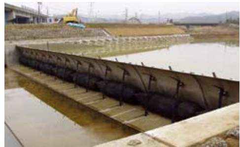
写真-1 鋼製起伏堰（ゴム袋体支持式）：SR 堰
