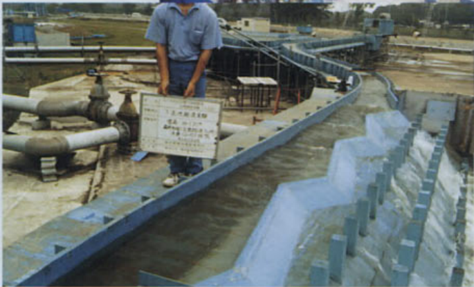
白子川比呂橋地下調節池(東京都)
