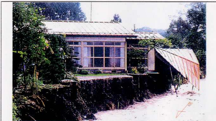
写真-5.5.7 洗掘による護岸の 被災事例
