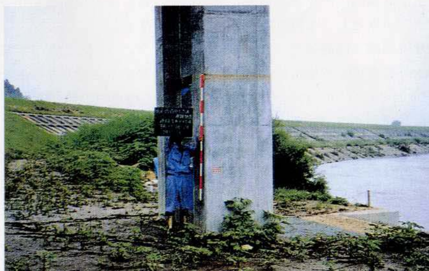
写真－1 橋脚に残された泥の付着による観測例
