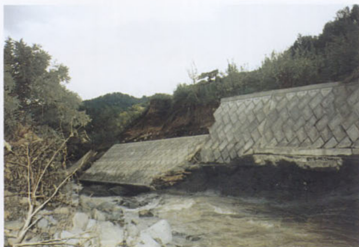
写真2-3 基礎部の河床洗掘による護岸被災事例
