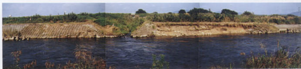
写真2-4 河岸侵食によるすりつけ護岸の被災事例
