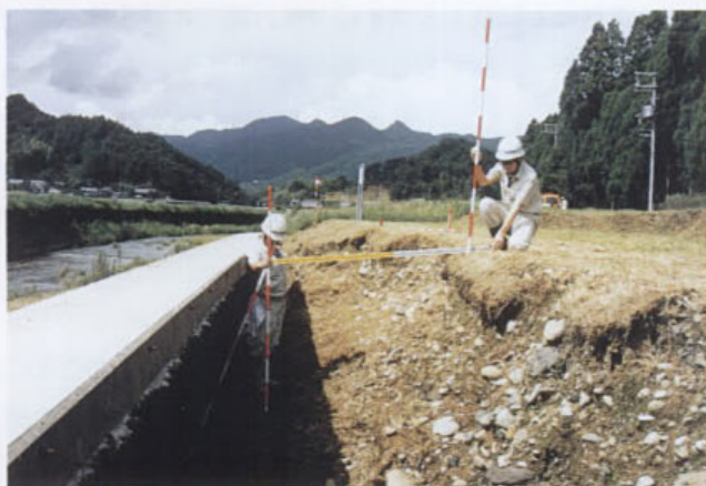
写真 2-6 法覆工背後の土砂流出事例
