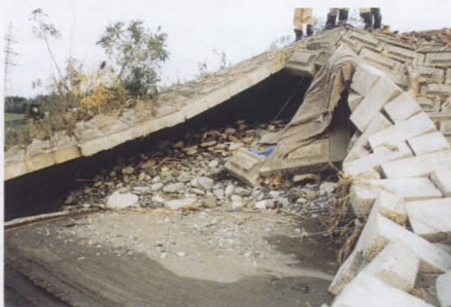
写真 2-7 連節型ブロック背面土砂の流出事例
