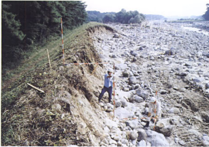
写真 2-1 堤防の侵食被災事例
