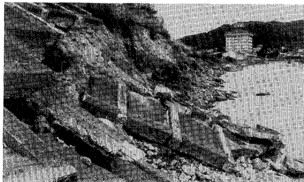
② 洗掘によるもの
