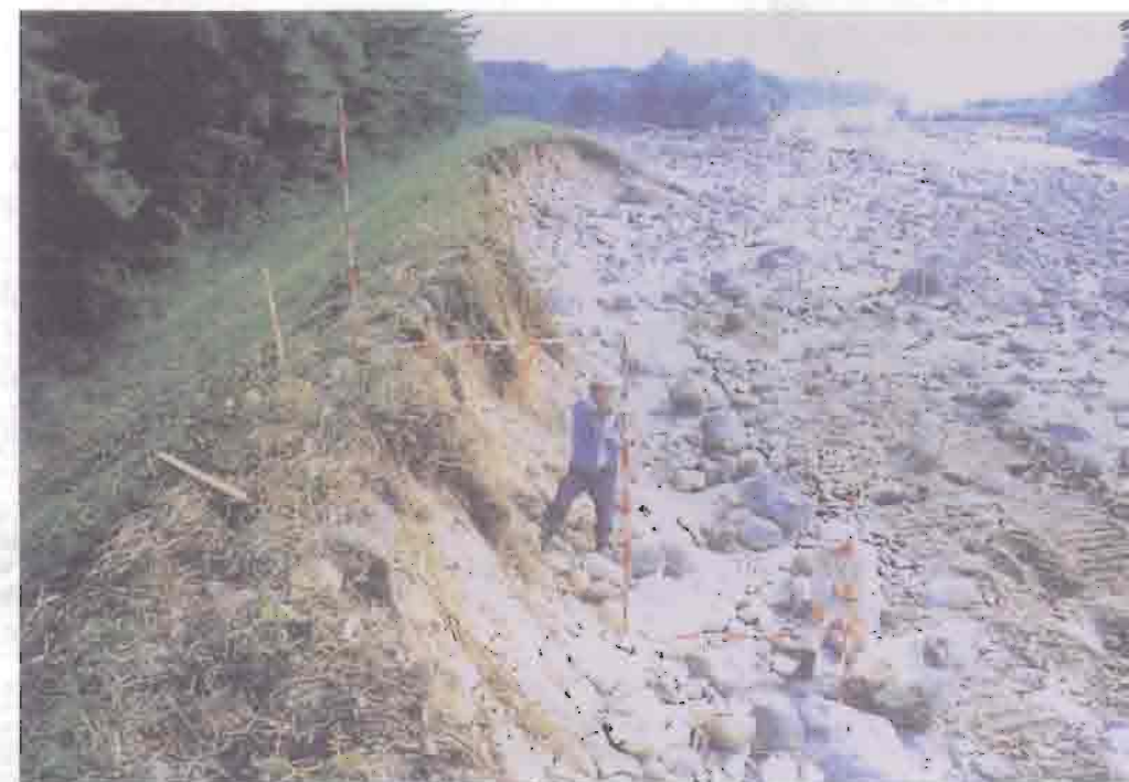
写真3 侵食による堤防被害の事例
