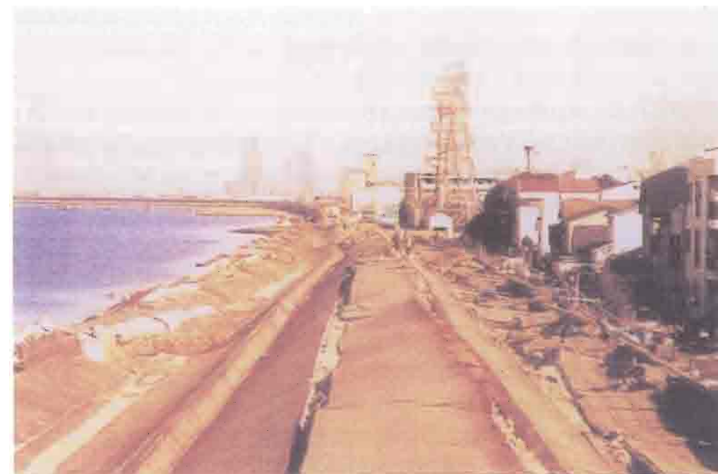
写真4 地震による堤防被害の事例
