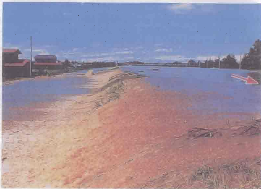
写真1 越水状況の事例
