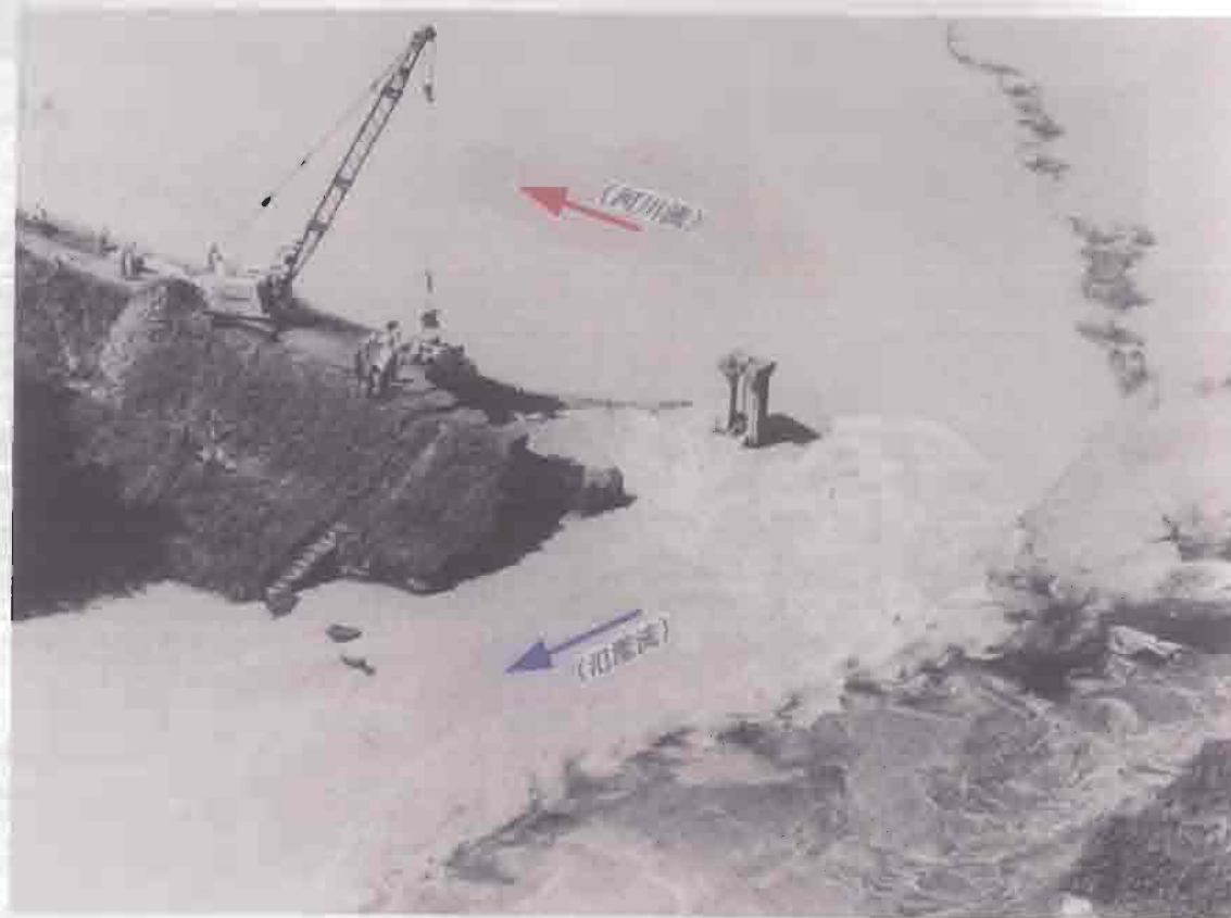
写真5 構造物周辺の堤防の被害の事例
