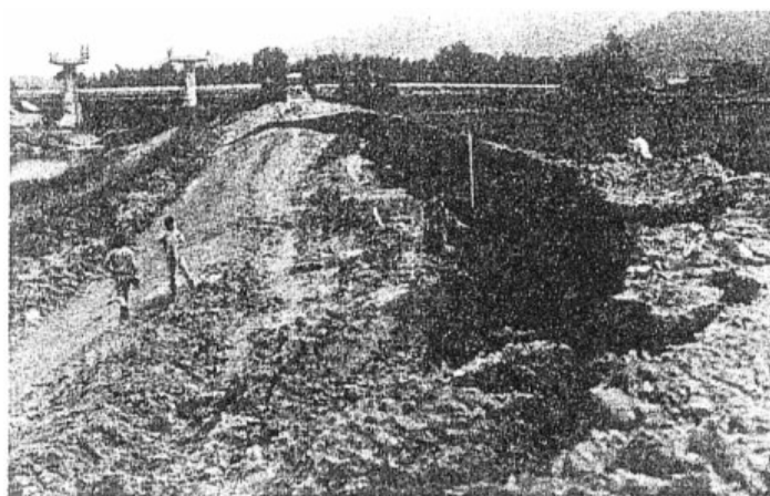
写真 2.1.1 築堤のすべり破壊(九州地方整備局)
