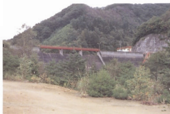
越流部と他の部分とで、高欄の高さと材質が異なり、連続性が保たれていない。
