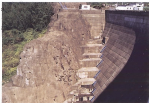
フーチング部の管理用階段の配置・形状が不規則である。
