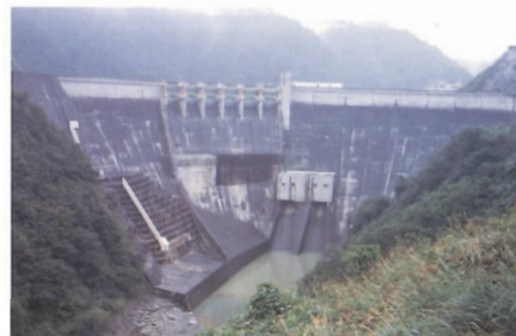
黒カビによる汚れがほぼ全体に広がっている。
