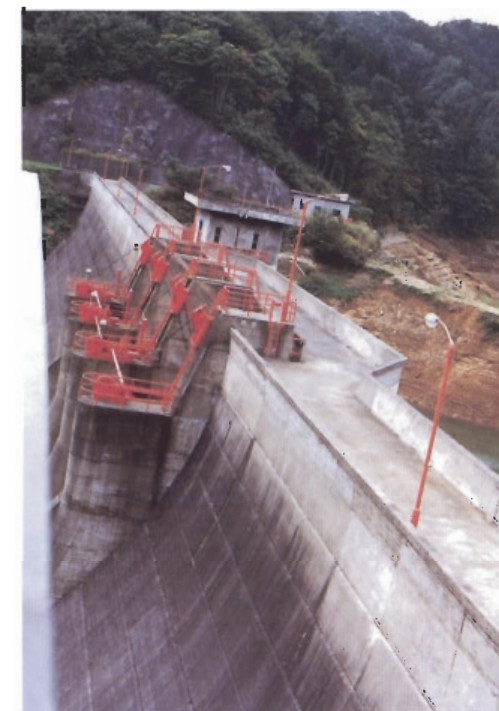
照明設備の高さ、照明方向が統一されていない。
