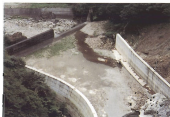
地山と減勢工導流壁との間が空いており、連続性がない。また、導流壁面が単調で変化に乏しい。
