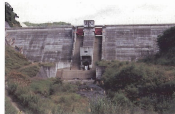
中央部に置かれた放流設備の建屋の形状が調和を乱している。
