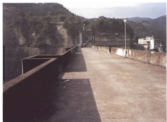
コンクリート製の高欄が汚れており、快適性に欠けている。
