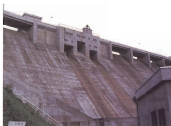
常用洪水吐からの水筋で導流面が汚れ、景観を損ねている。
