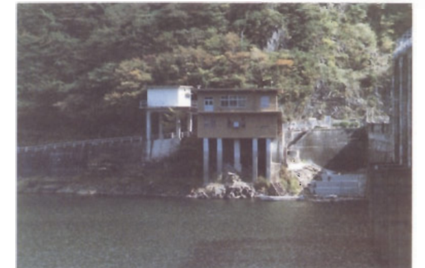
管理棟下部の露出したピアの処理が無造作で周囲の景観を害している。
