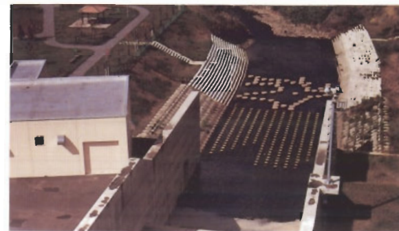
下流河川と減勢工部との連続性がない。
