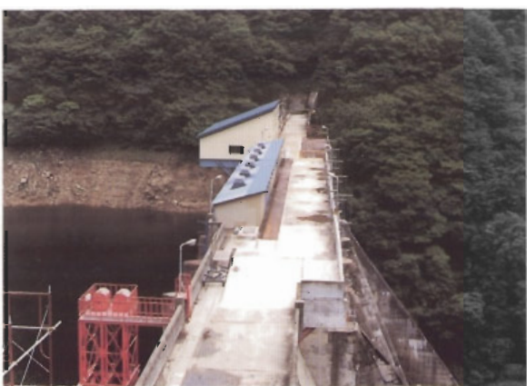
下流側高欄が洪水吐部でカギ型に張り出し、連続性を損ねている。
