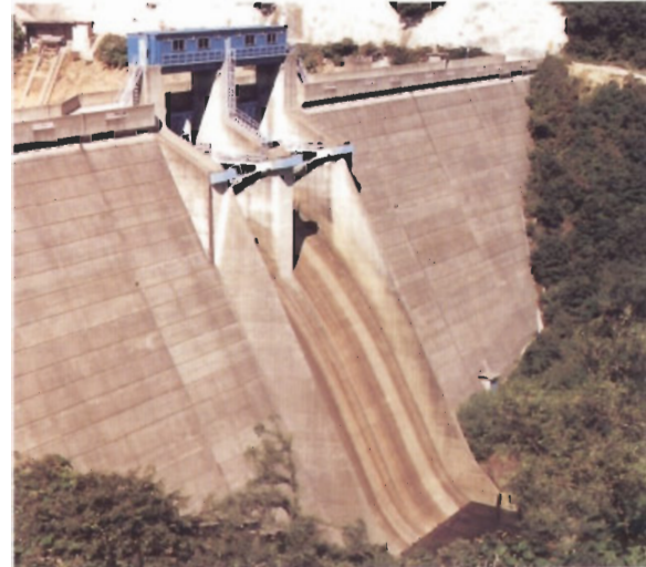
〔木地山ダム：山形県〕 フーチング部が樹木によって覆われ、目立たなくなっている例。
