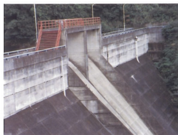
下流表面と天端付近の鉛直面との接合部の形状が、連続性を阻害している。
