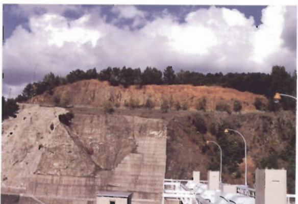
多種の法面工を用いた結果、統一感に欠ける景観を出現させている。
