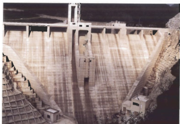
全面が法枠工で施工され、痛々しい景観を呈している。周辺の自然との調和が見られない。
