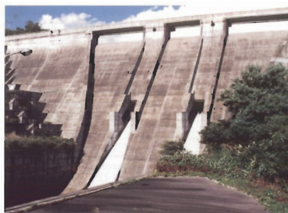
常用洪水吐付近の導流壁の形状が連続性を阻害している。
