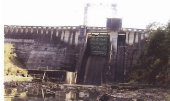
下流河川との連続性がなく、また周辺に消波ブロックが散乱して荒涼とした景観を呈している。
