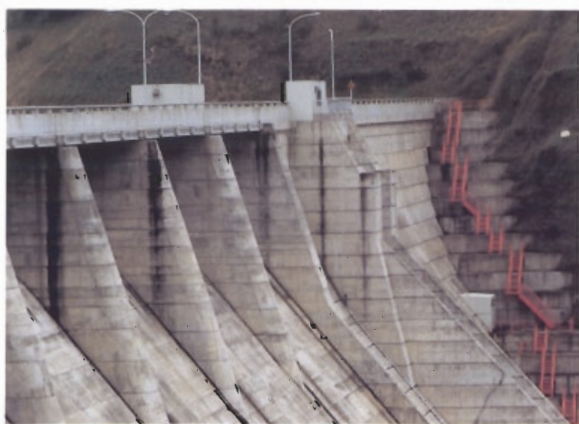
フーチングが汚れている。
