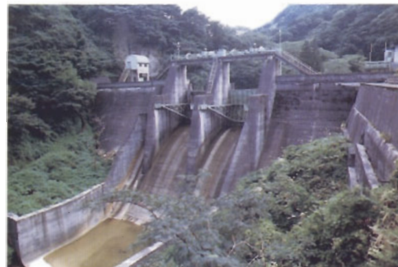
天端にゲートピアが突出し、その上にゲート巻き上げ装置等の機械が露出して外観がすっきりしていない。
