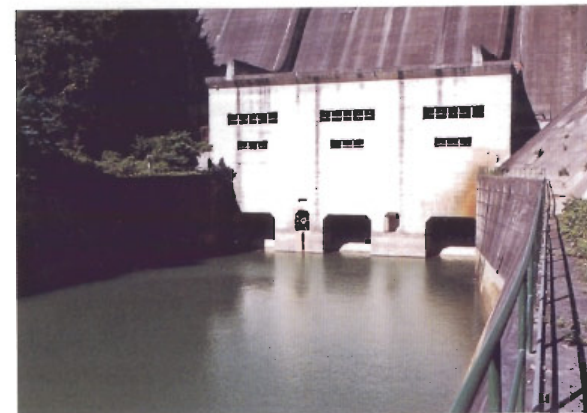
建屋の中で露出したバルブが目立っている。放流口下部のコンクリート表面も汚れている。
