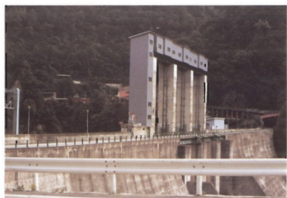
上流側がコンクリート、下流側が鉄となっており、材質のバランスが保たれていない。配色も統一感に欠けている。
