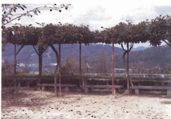
パーゴラの鉄製パイプが錆びたままとなっており、展望施設を貧弱なものに見せている。
