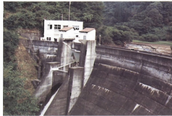
ゲートハウスが天端より高く突出して目立っており、形状、材質、配色も全体との調和に欠けている。
