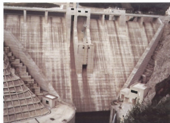
フーチング部と導流壁との間が離れており、一体感に乏しい。
