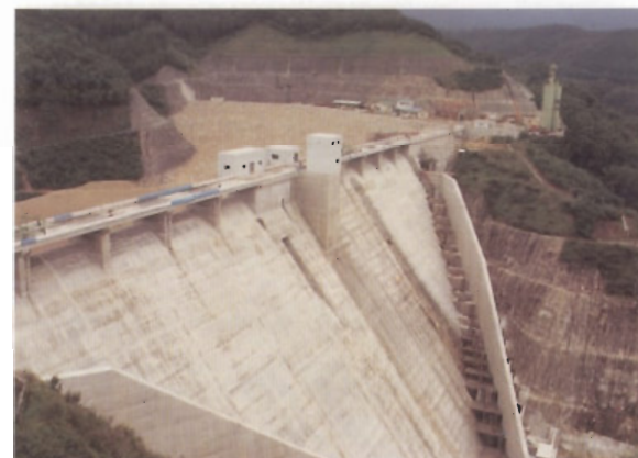
導流壁に接するフーチング部の高さ、大きさが一定でなく、また、導流壁の高さが目立ち、一体感に乏しい。
