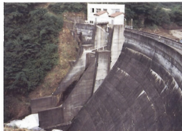
エフロレッセンス（多湿により生ずる塩類の析出物）がコンクリート表面に析出し、汚れが目立つ。
