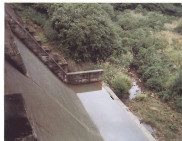
自然の減勢部と導流部との間が段差となっており連続性がない。
