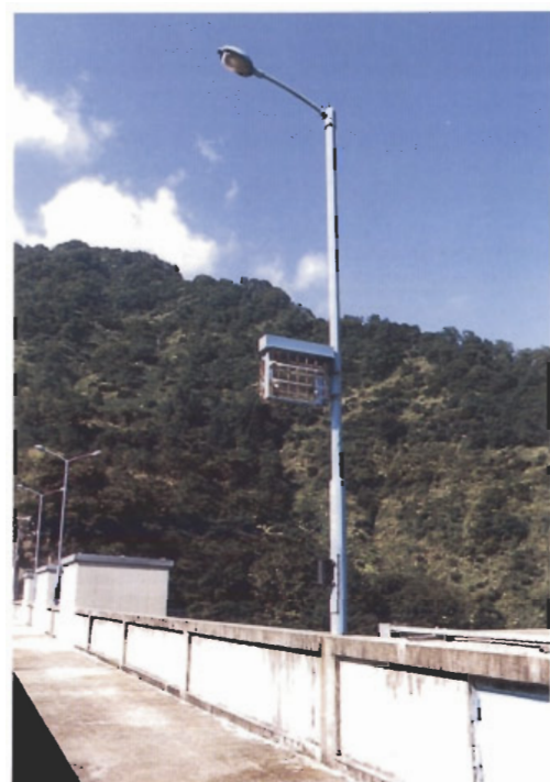
照明設備に付属機器が付き、シンプルな外観を損なっている。
