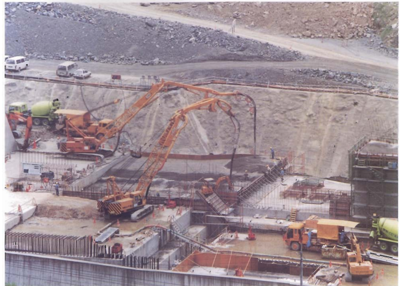
コンクリートボリュームが大きいブロックの打設状況 2セット使用して打設を行った。
