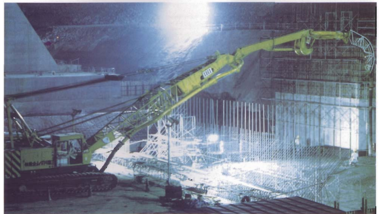
夜間打設状況 7月15日～9月15日はコンクリート温度を考慮して夜間打設とした
