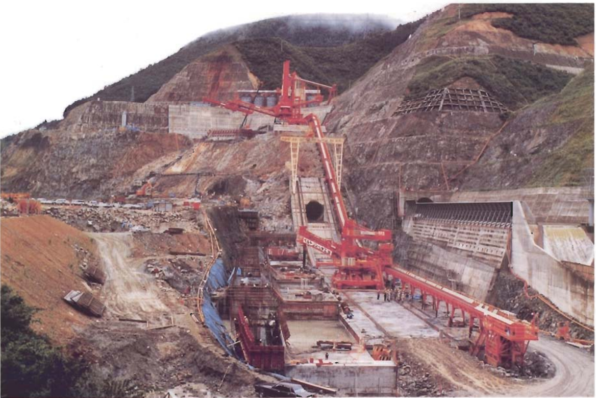
ベルトコンベヤシステム全景
