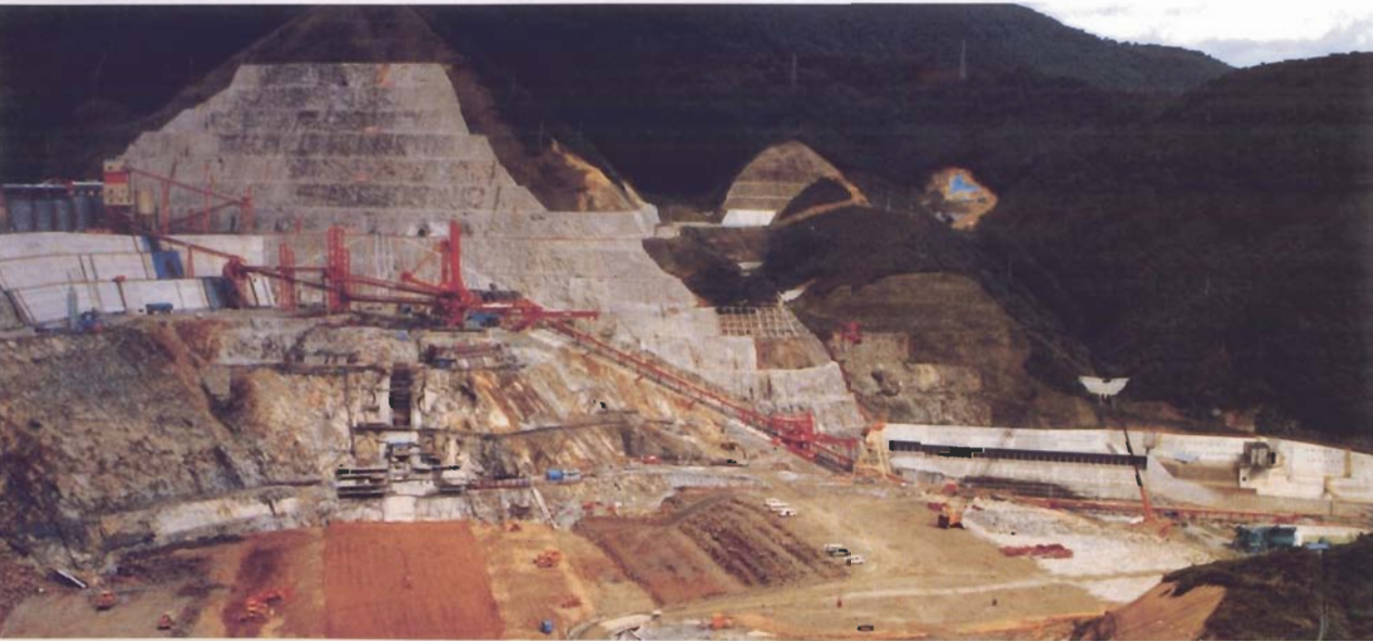
ベルトコンベヤシステム全景
