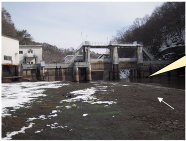
大宮ダム貯水池内の堆砂状況 (H20) ～貯水位低下時の写真～
