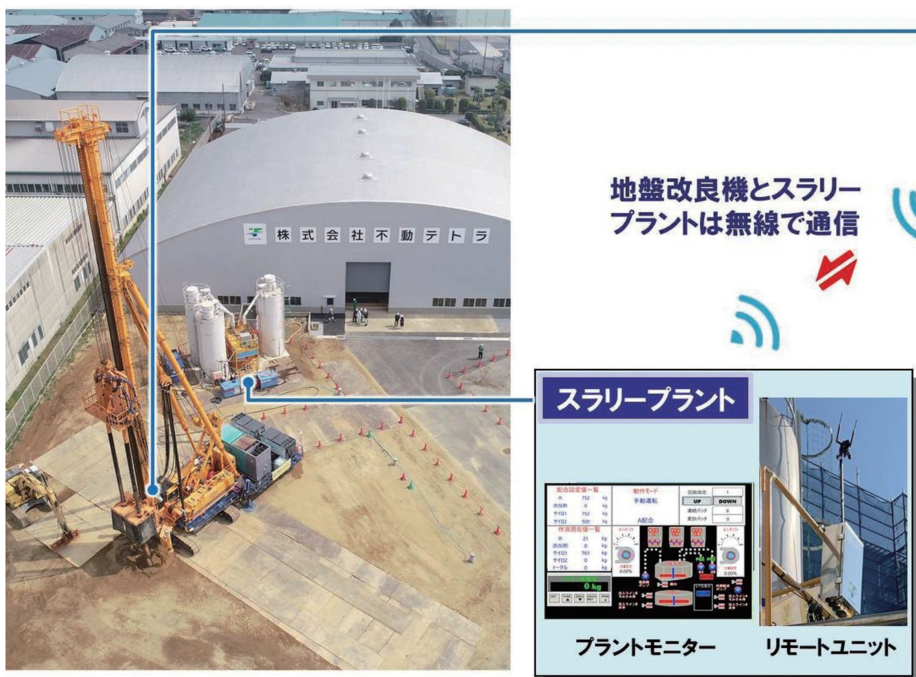
GeoPilot-AutoPileのシステム概要
