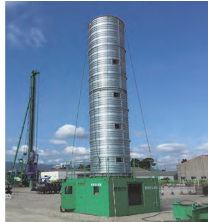
写真-2 騒音防止装置の背面側
