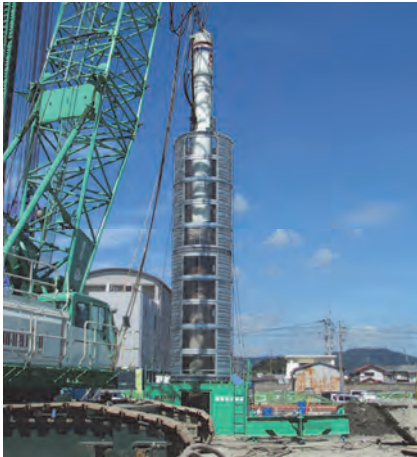
写真-1 騒音防止装置の正面側
