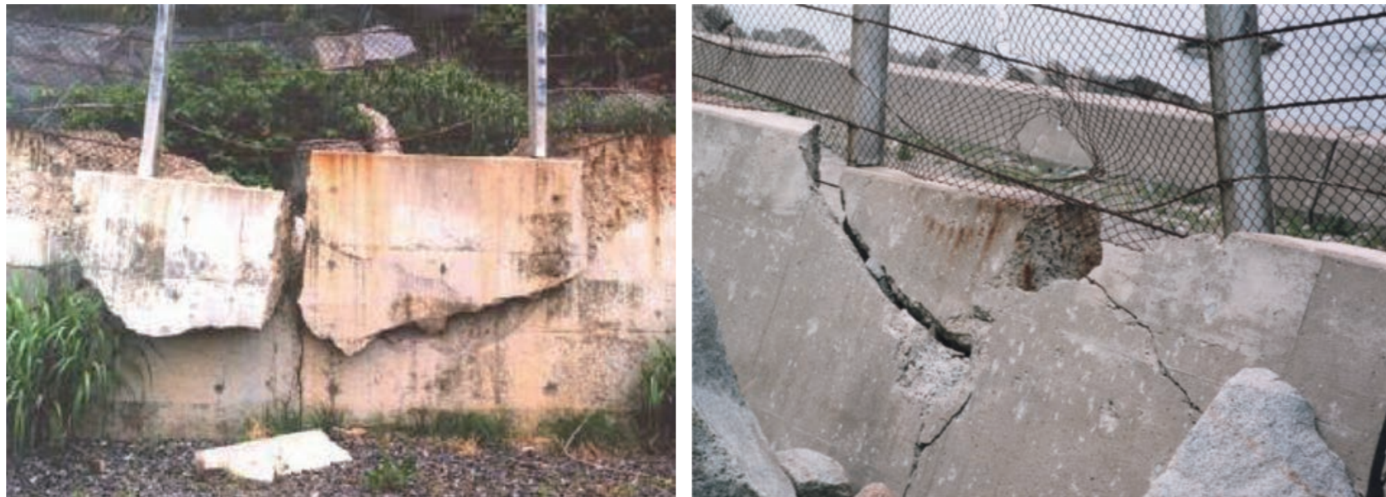
写真-1 落石防護擁壁の損傷事例
