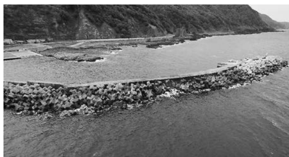
写真－1 防波堤 消波ブロック破損・沈下状況
