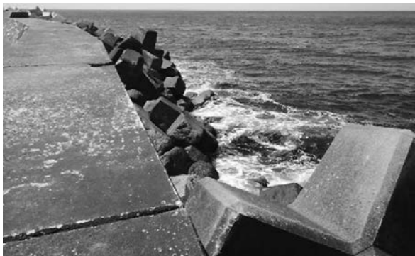
写真-2 防波堤 消波ブロック破損・沈下状況
