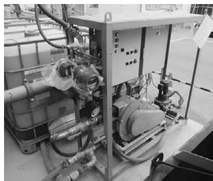
写真-2 コンパクトな二次処理剤自動添加装置
