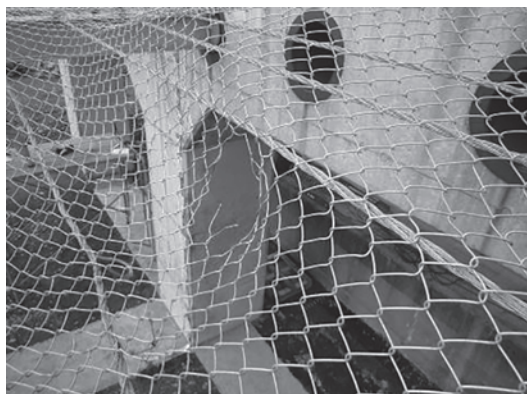
写真-3 金網の損傷状況
