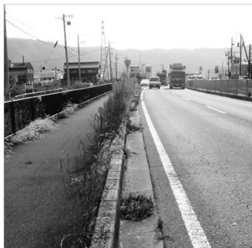
写真－2 雑草が繁茂する道路
