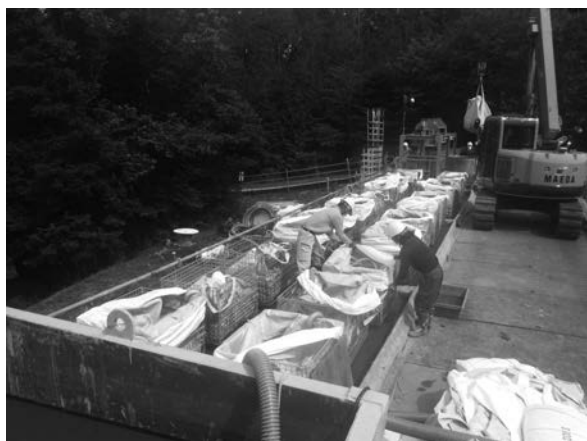
写真-5 脱水処理設備
