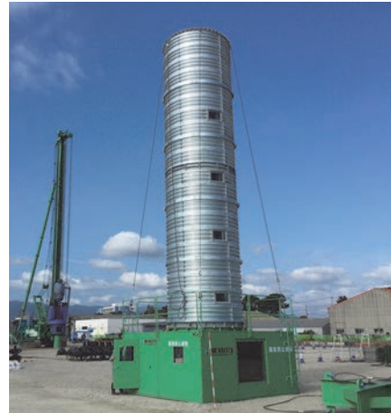
写真-2 騒音防止装置の背面側
