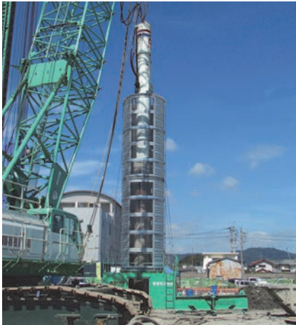
写真-1 騒音防止装置の正面側
