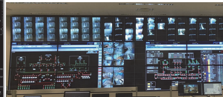
写真-2 災害時における電力制御状況
