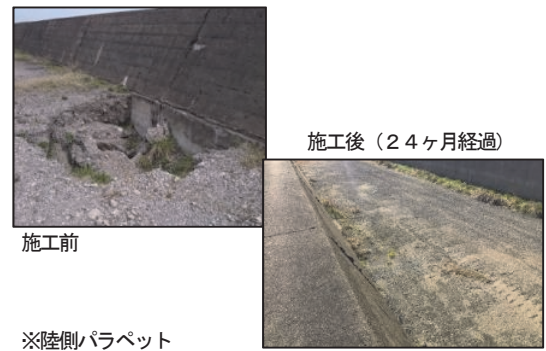
※陸側パラペット 写真-2 陥没状況・設置経過
