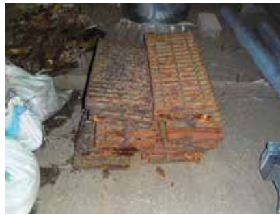
写真-2 高速道路本線で発生した腐食した集水柵用グレーチング
