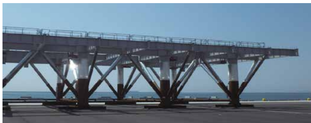
写真—2 : 栈橋ジャケットへの耐海水ステンレライニング適用例
