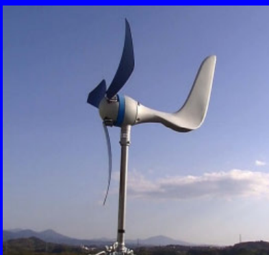
福島大学の7階建ての理工棟の屋上におけるカエドの種型風車
