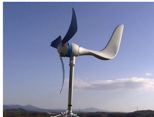
Fig. 4 福島大学の 7 階建ての理工棟の屋上におけるカエデの種型風車
