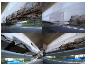
G1損傷状態
