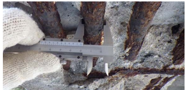
写真-9 主鉄筋の錆びによる断面欠損
