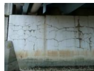
ASRIによる橋台の損傷
