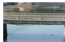
塩害によるRC橋の損傷
