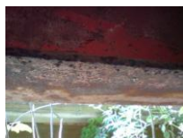
主桁腐食の進行
