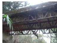
トラス部材の破断
