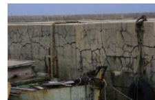
ASRIによる防波堤の損傷
