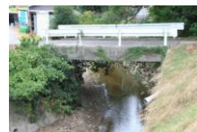
【事例2】橋台の水平ひび割れ
