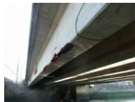
塩害によるPC橋の損傷
