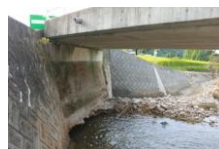
【事例1】橋台基礎の洗掘
