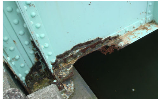
写真-11 腐食による主桁断面欠損（京都府北部地域）
