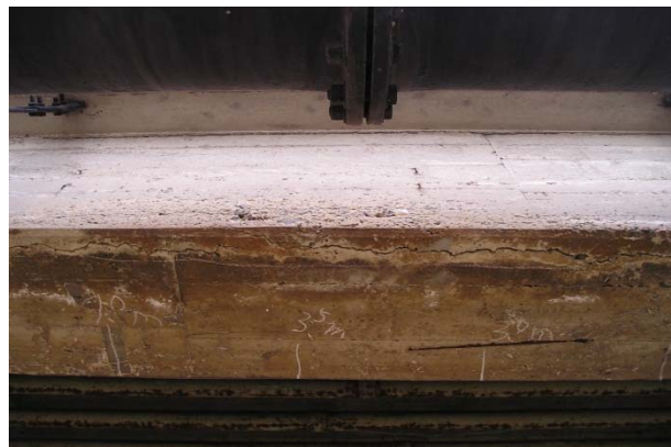
写真-4 RCT 桁ゲルバー橋の塩害損傷事例（京都府北部地域）
