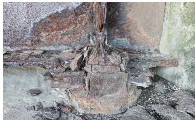
写真-14 支承部の腐食損傷状況（香川県）
