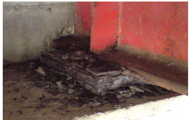
写真-13 支承部の腐食損傷状況（徳島県）
