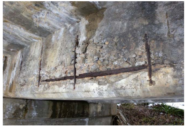
写真-1 RCT 桁橋主桁の中性化損傷事例（京都府北部地域）
