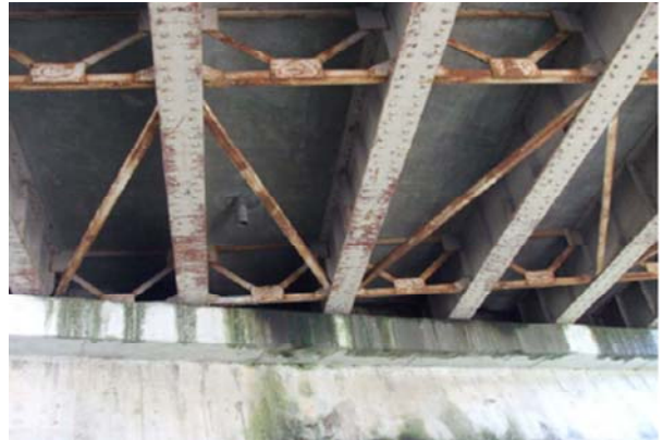
写真-12 鋼桁の腐食損傷状況（山口県）
