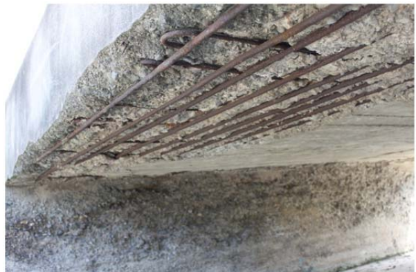
写真-2 床板橋の中性化損傷事例（香川県）
