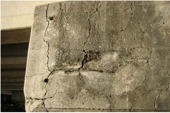
写真-10 ASRによる損傷を受けた橋脚（香川県）
