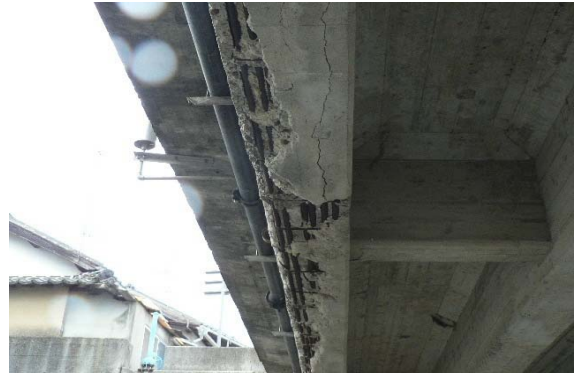
写真-6 RCT 桁橋の塩害損傷事例（香川県）
