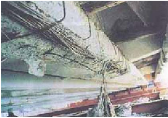
写真-5 RCT 桁橋の塩害損傷事例（山口県）
