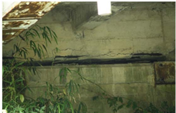
写真-3 連続RCT 桁橋支点上横桁の中性化損傷事例（香川県）
