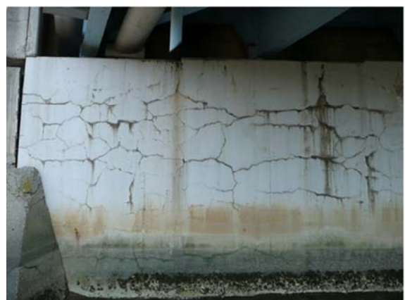
写真-9 ASR による損傷を受けた橋脚（山口県）
