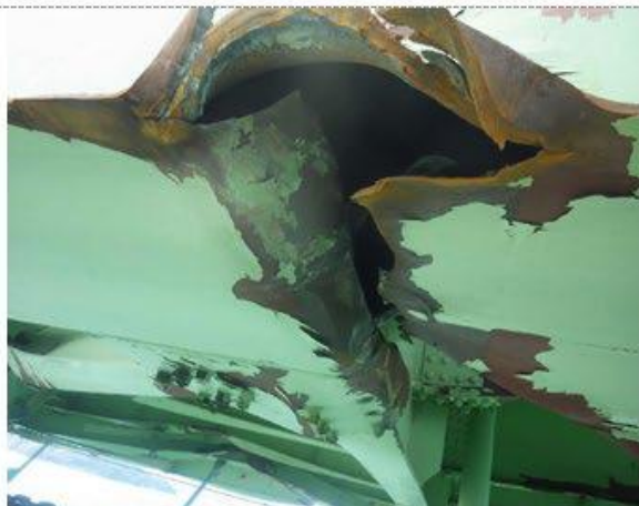
(b) 下弦材損傷部（広島側） ←
