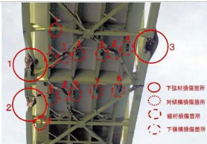
(b) 事故による損傷状況
