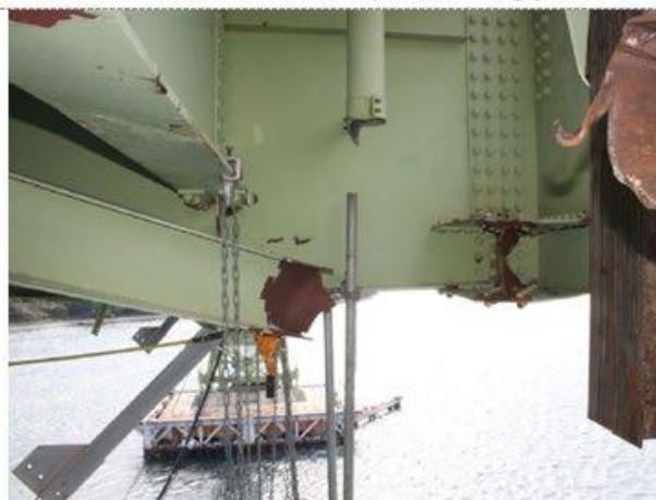
(f) 下横構破断部 ←
