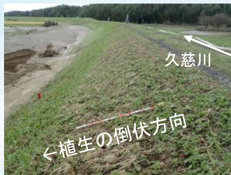
左岸27.0k(決壊箇所下流)
