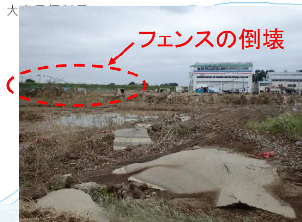
④フェンスの堤内地側への倒壊
