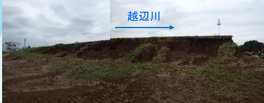
①越流水によると推定される川裏部の洗掘
