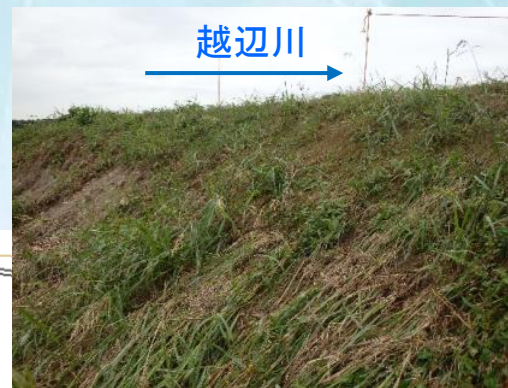
③川裏部の川裏側への植生の倒伏
