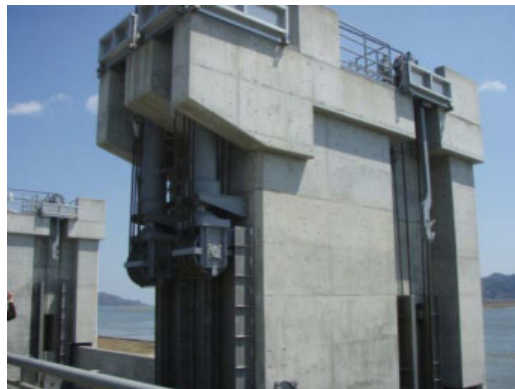
機側操作盤を設置している堰柱
