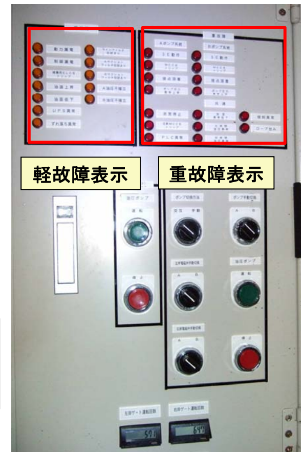
油圧ポンプ関係操作盤
