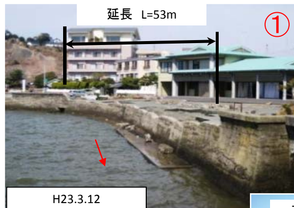
①パラペット堤破損
