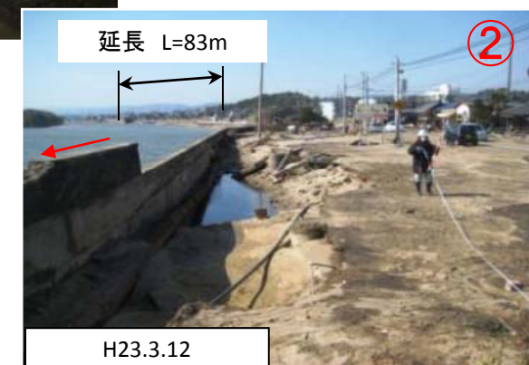
②背面(堤内地)吸出し
