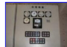
予備発電設備状況（損傷なし）
