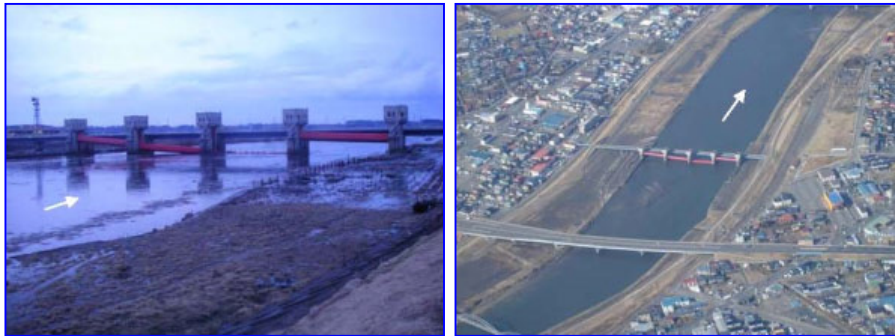
1号、2号、4号ゲート片吊り状況（津波到達後）
