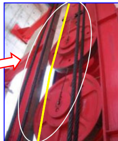
戸当りレール曲がり
